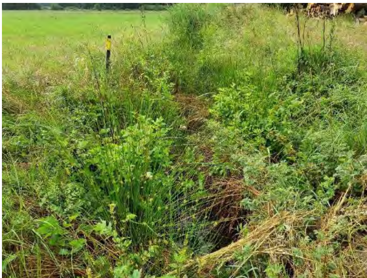
NVO 57: Öppet dike, klass 3 (preliminärt).
