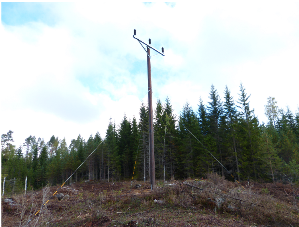
Figur 6. På berg fästs stolpen med järn nedborrade i berget och med staglinor i stål, även de med infästningar borrade i berget.
