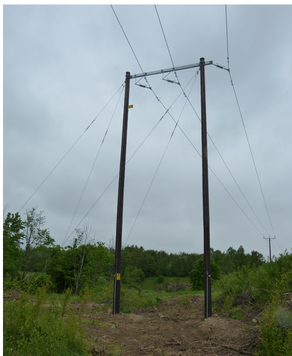
Figur 7. En stagad stolpe med två ben, för ytterligare stabilitet, som används där ledningen byter riktning.
