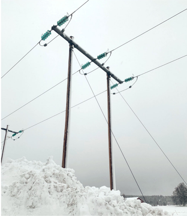
Figur 3. Exempel på träportalstolpar tillhörande befintlig luftledning AL21S2.
