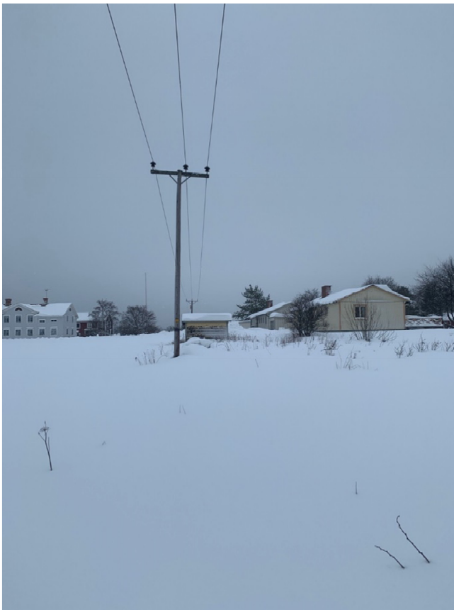
Figur 4. Exempel på enkelstolpe tillhörande befintlig luftledning AL21S2
