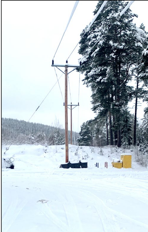
Figur 3. Enkelstolpe tillhörande AL12S2.
